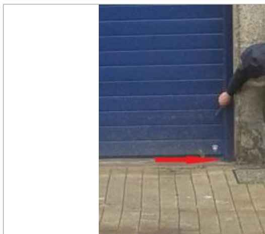
Laisse de crue sur la porte de garage au niveau du crayon
