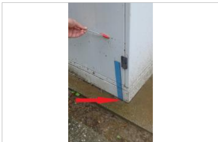
Laisse de crue sur coffret EDF au niveau du crayon
