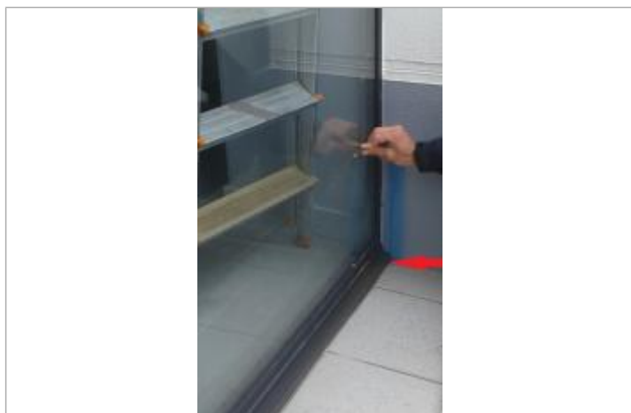
laisse de crue à l'extérieur de la baie vitré du magasin
