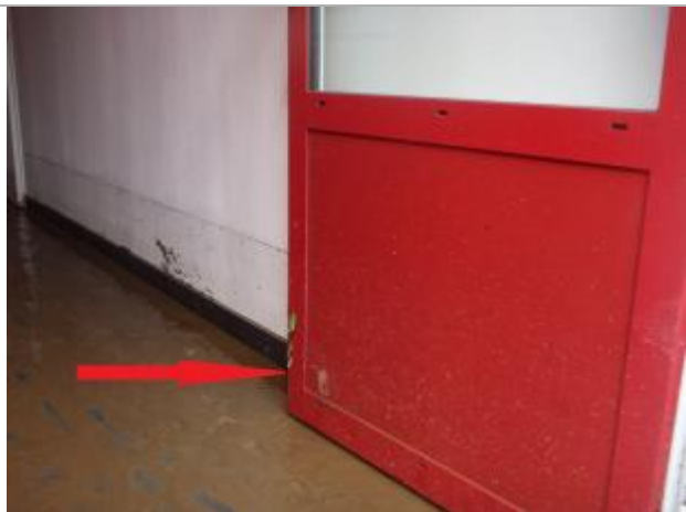
laisse de crue à l'intérieur du bâtiment
