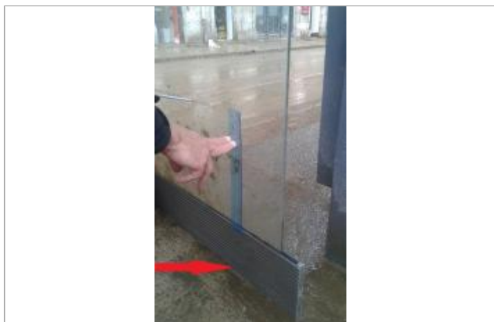
Laisse de crue au niveau de l'arrêt de bus
