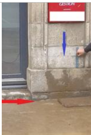
Laisse de crue sur la façade du bâtiment
