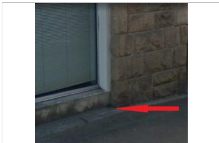
Trottoir au droit du côté droit de la baie vitré
