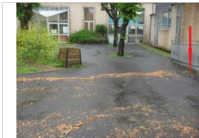
laisse de crue à l'intérieur de la cour de l'école
