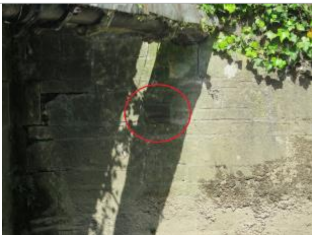
Repère de la crue du 4 janvier 1936
