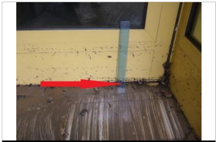
Seuil de porte d'entrée du magasin
