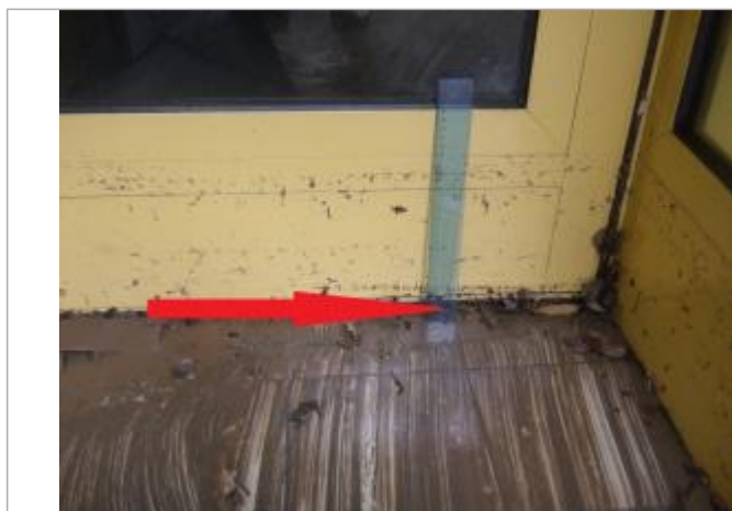
Seuil de porte d'entrée du magasin
