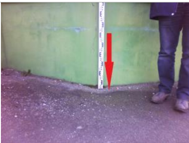
Sol à l'angle du bâtiment (dernier coin avant la barrière du poste de garde)
