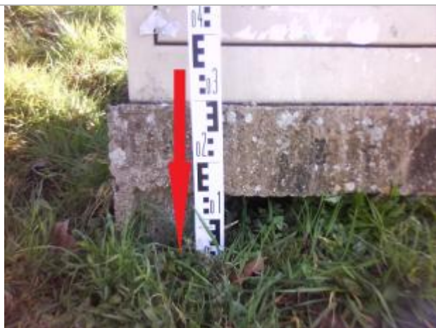
Sol / coin gauche en façade de l'armoire technique
