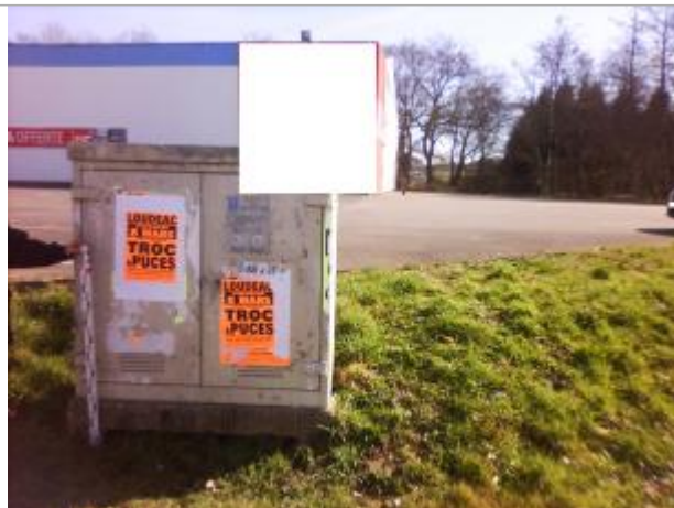
Armoire technique compteur de gaz
