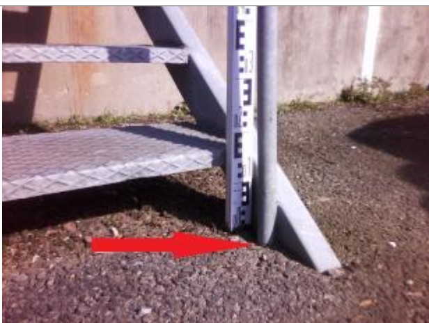
Sol au droit de l'escalier
