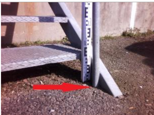
Sol au droit de l'escalier
