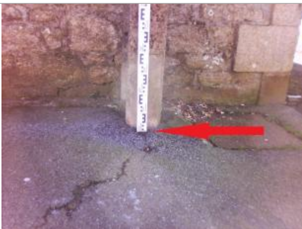
Sol du trottoir au pied du poteau EDF
