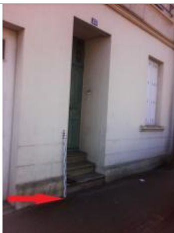
Sol du trottoir (pied du bâtiment au droit de la porte d'entrée du 43)
