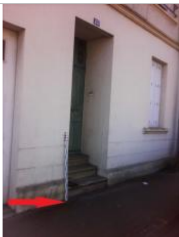
Sol du trottoir (pied du bâtiment au droit de la porte d'entrée du 43)
