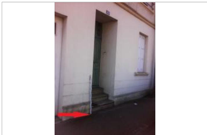
Sol du trottoir (pied du bâtiment au droit de la porte d'entrée du 43)
