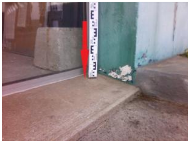
Sol du côté droit du seuil de la porte du garage
