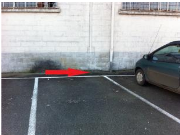
Sol à proximité de la gouttière
