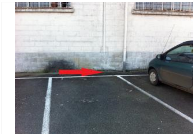
Sol à proximité de la gouttière
