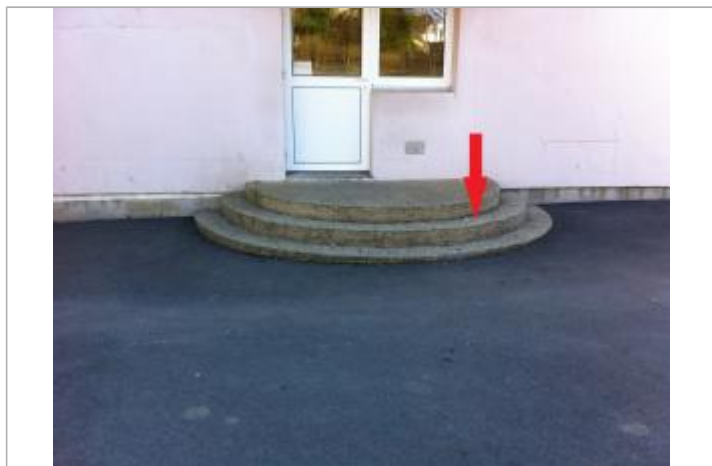
2ème marche, en partant du bas, de l'escalier devant le bâtiment
