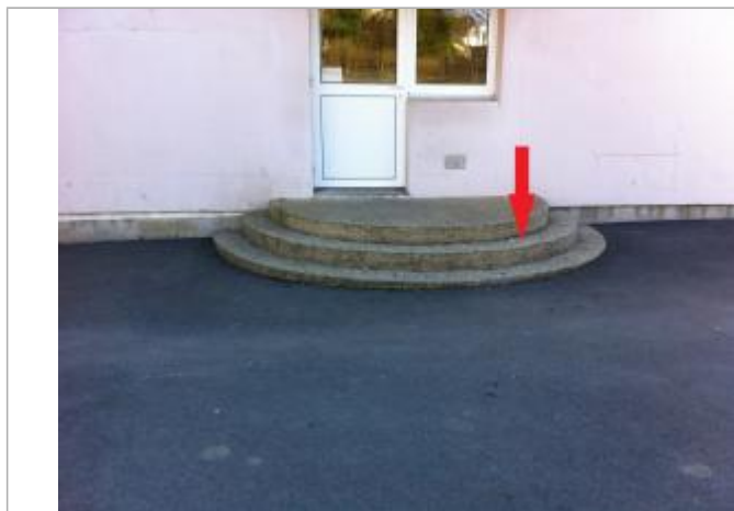
2ème marche, en partant du bas, de l'escalier devant le bâtiment
