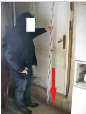
Sol garage - au droit de la porte intérieure donnant dans le garage
