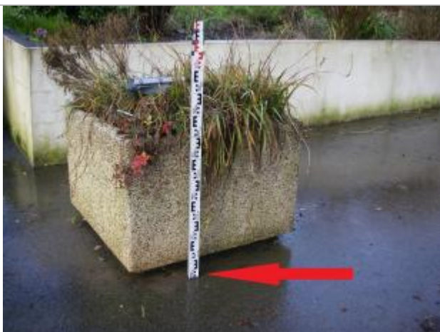
Sol au pied jardinière publique - au droit du côté face à Aulne
