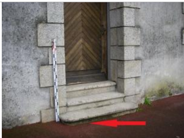
Sol au droit de la marche la plus basse
