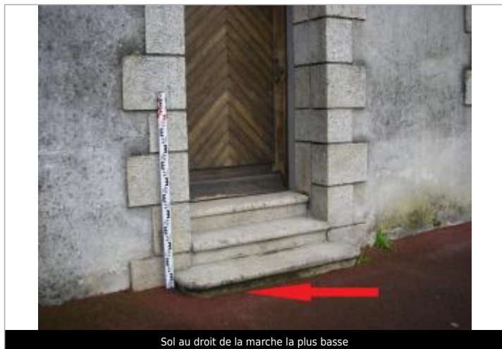
Sol au droit de la marche la plus basse
