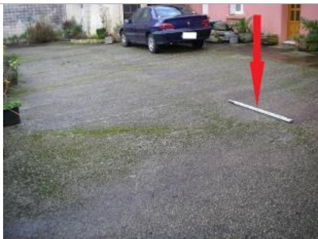
Cour de l'habitation - Sol au niveau de la fissure dans l'enrobé
