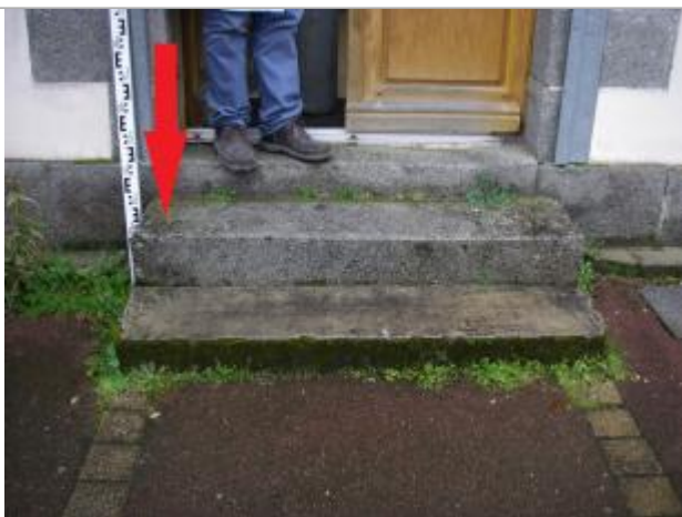
Sous le seuil de la porte d'entrée du bâtiment
