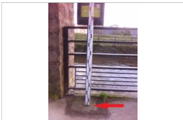
Sol du trottoir entre le panneau HIPPODROME et le garde corps
