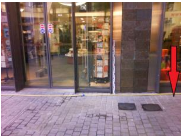
Sol le long de la vitrine dans le passage couvert - à droite de la porte de sortie - sur le montant droit du pilier couvert de céramique.
