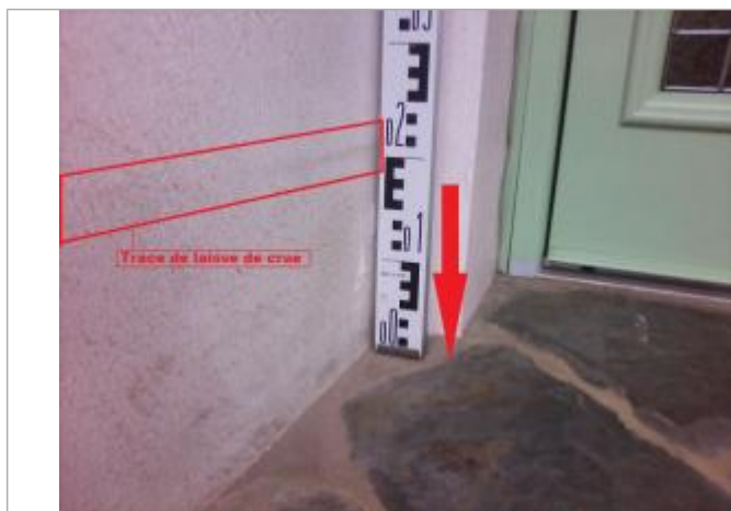
Sol extérieur devant la porte d'entrée avec laisse de crue sur le mur gauche
