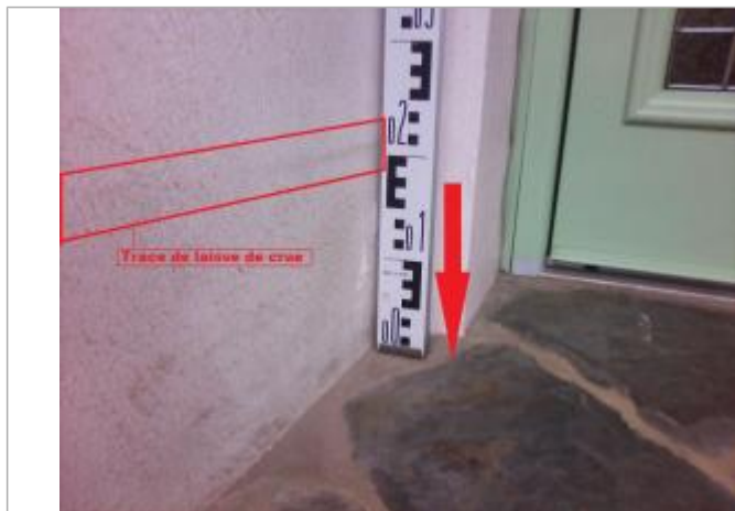
Sol extérieur devant la porte d'entrée avec laisse de crue sur le mur gauche
