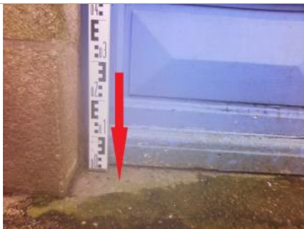
Seuil de la porte d'entrée du bâtiment
