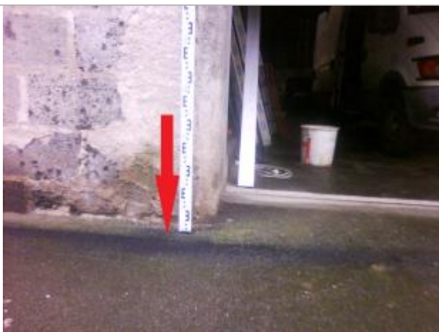
Sol du trottoir au droit du mur gauche de la porte de garage
