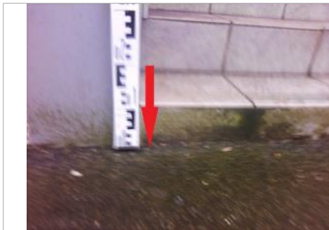
Sol du trottoir au pied de l'escalier
