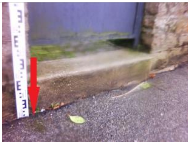
Sol du trottoir au droit du montant de la porte d'entrée du jardin
