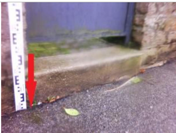
Sol du trottoir au droit du montant de la porte d'entrée du jardin
