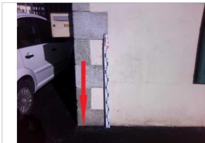
Sol au pied du mur (angle gauche du bâtiment)
