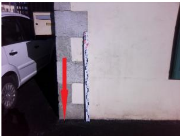
Sol au pied du mur (angle gauche du bâtiment)
