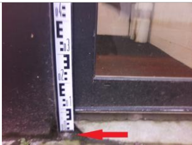
Sol au droit de la porte d'entrée du magasin
