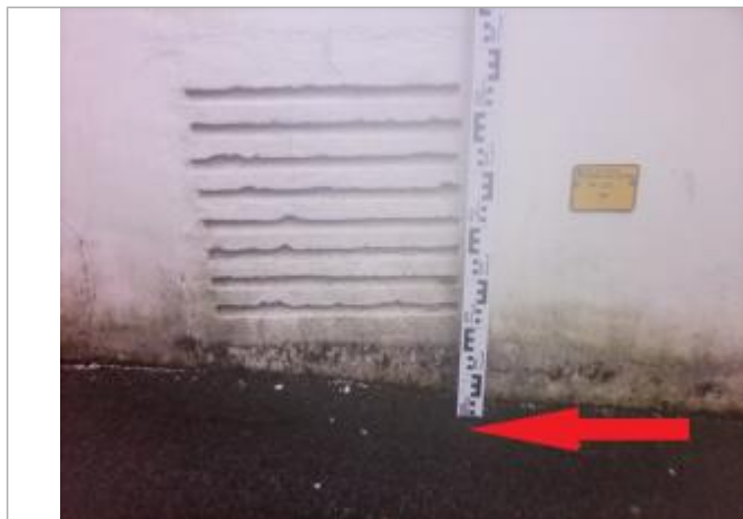
Côté droit de la prise d'air du local électrique ( sur le trottoir )
