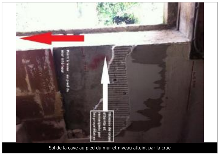
Sol de la cave au pied du mur et niveau atteint par la crue
