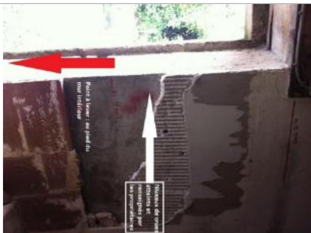
Sol de la cave au pied du mur et niveau atteint par la crue
