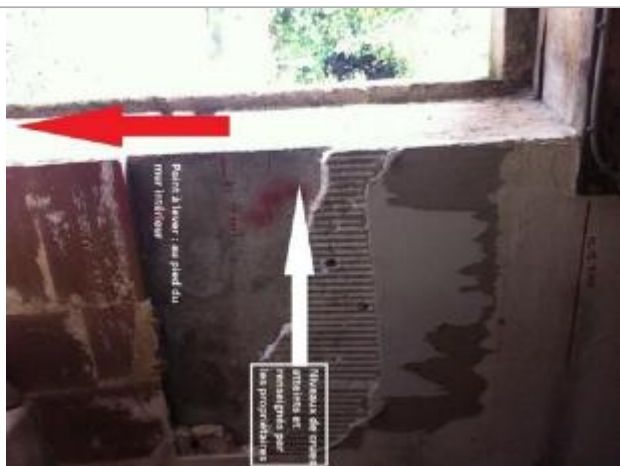
Sol de la cave au pied du mur et niveau atteint par la crue
