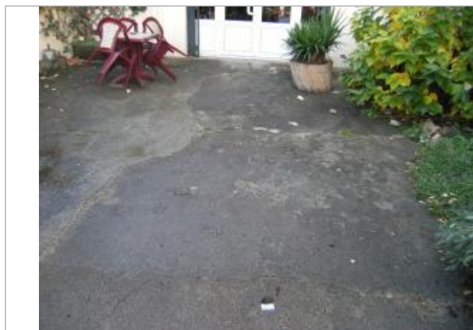
Arrivée de l'eau au niveau de la fissure au milieu de la terrasse
