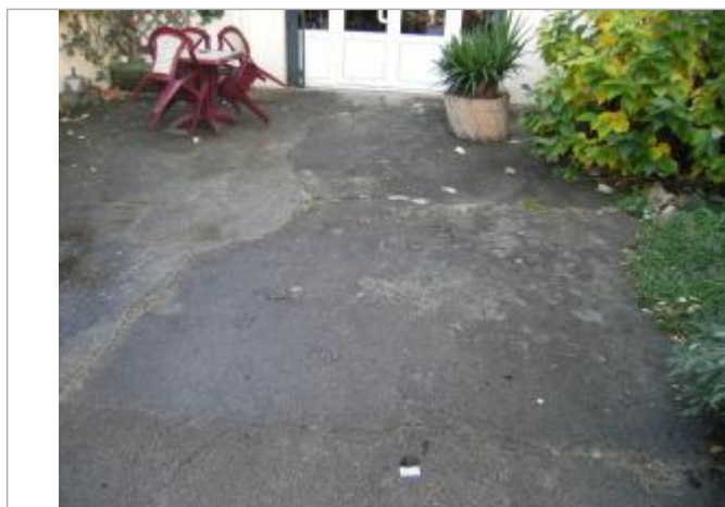
Arrivée de l'eau au niveau de la fissure au milieu de la terrasse
