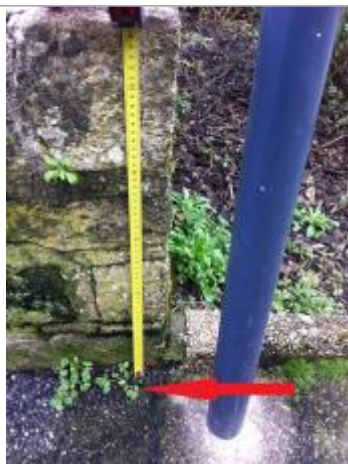
Sol au droit du muret
