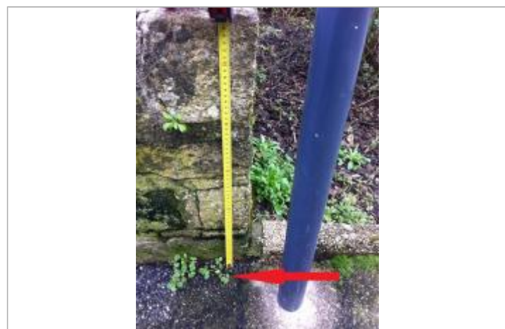
Sol au droit du muret
