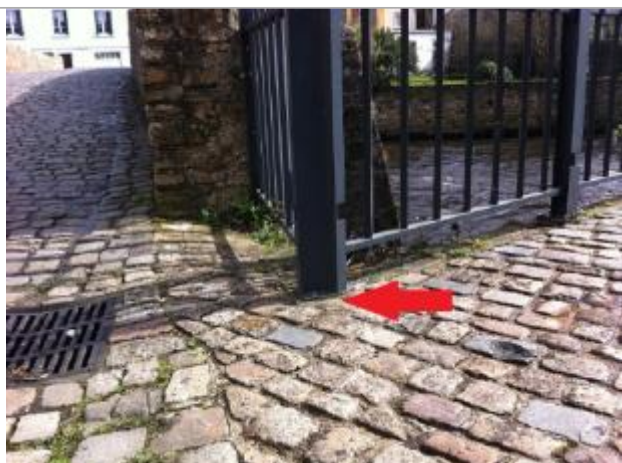
Sol au droit du garde-corps du pont
