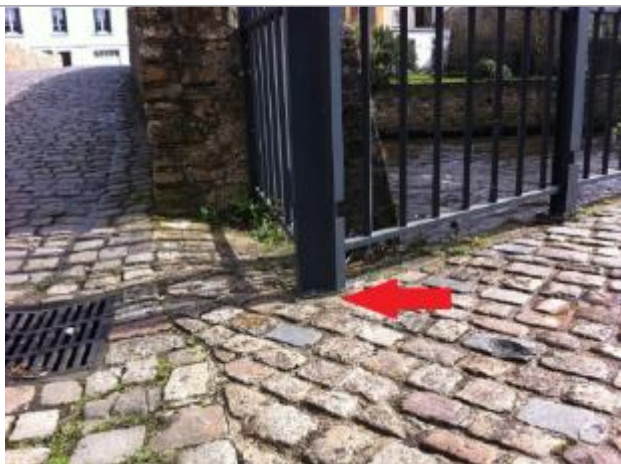
Sol au droit du garde-corps du pont
